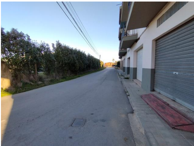
C. Mestral. Vista de la calçada i de la vorera inaccessible per a PMR
